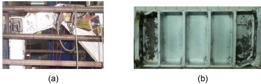
Gambar 1 Kegagalan Pada Pelat Sayap Link 4,5)
